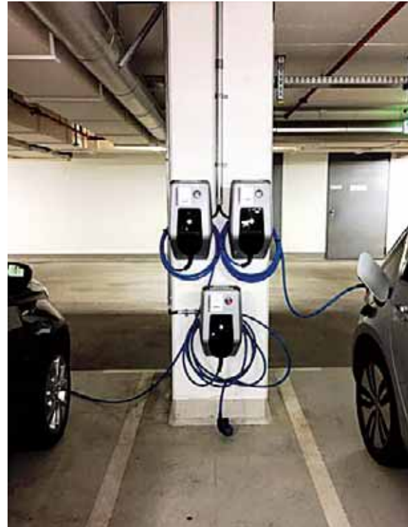
Abbildung 3: Fest installierte Wallbox
